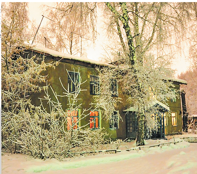
В программу капремонта попадают дома, которые уже нужно сносить, а не ремонтировать.
