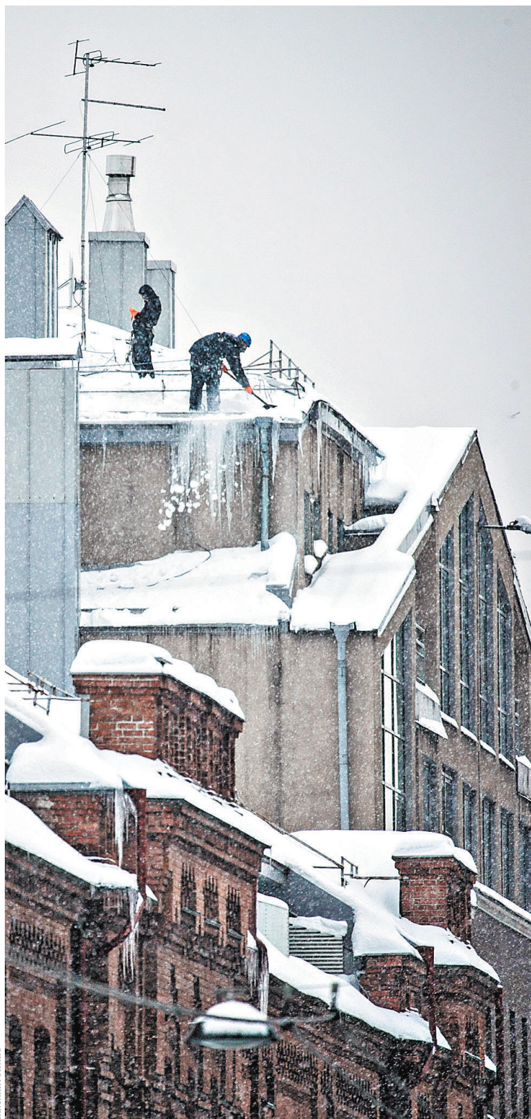
В Петербурге промышленные альпинисты оценивают свои услуги по очистке крыш от снега и наледей в среднем от 23 до 30 рублей за квадратный метр.
